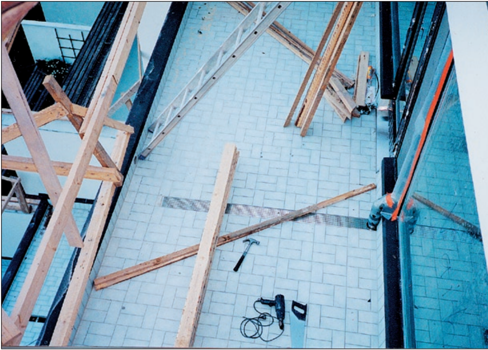
Riitankujan korjauksen varsinainen haaste olivat 17 neliön suuruiset terassit, jotka korjattiin perusteellisesti. Kuva: Isännöitsijätoimisto Vesa Itkonen Oy.
